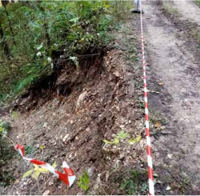
Uno dei due tratti ceduti in novembre 2023 della scarpata della strada forestale "Spiazzoni" in Val di Sella. (foto del custode forestale)
